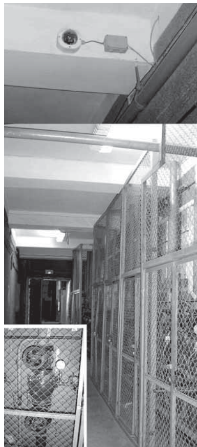
модернизированная система пожаротушения
