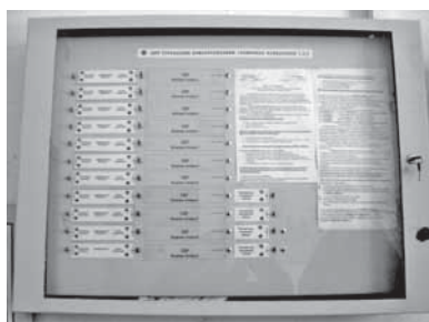
щит управления пожаротушением на посту дежурного
